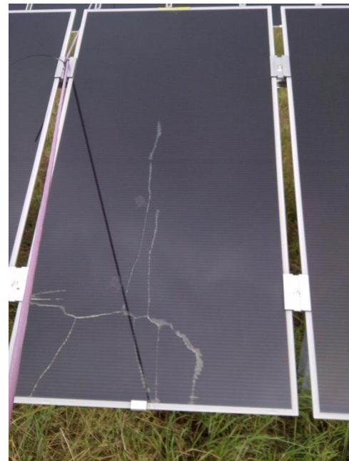
Abb. 33: Modulschädigungen Foto 2 (Foto: DiSUN Management & Service GmbH)
