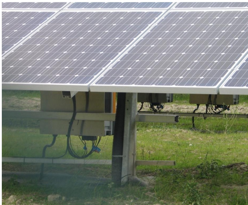
Abb. 35: Von den Wechselrichtern hängende Kabel/-schlaufen müssen vor Verbiss z.B. durch Leerrohren oder einen mobilen Weidezaun/ ein Weidenetz geschützt werden.
