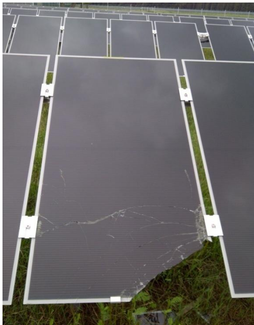
Abb. 32: Modulschädigungen Foto 1 (Foto: DiSUN Management & Service GmbH)
