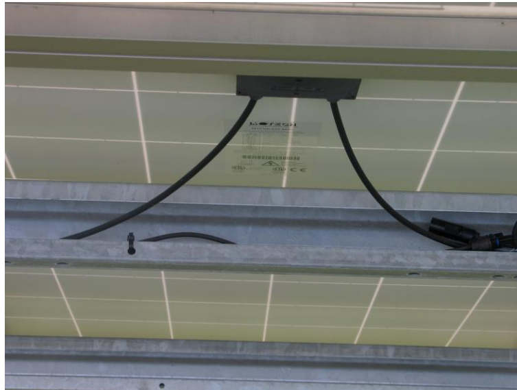
Abb. 26: Auch die Verlegung der Kabel im Ständerprofil verhindert das Befressen oder ein „Hängenbleiben“ der Schafe in der Verkabelung (Foto: M. Jurkschat).
